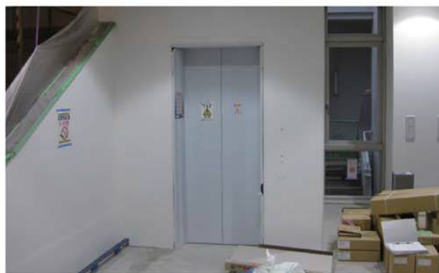
玄関ホール内のエレベーター
