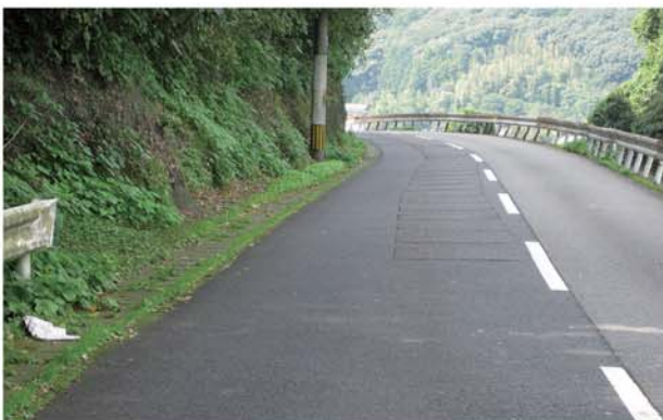
補修を必要とする神田線のイタチ山付近の町道
