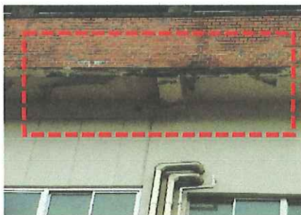
〔 外壁の剥離、爆裂部分 〕
