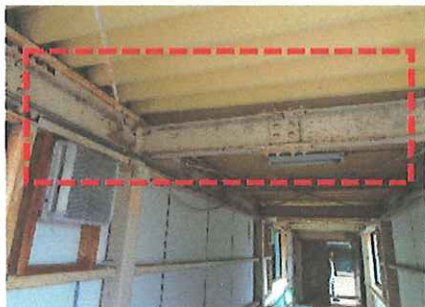
〔 渡り廊下の老朽化 〕
