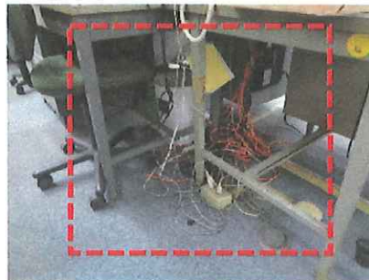
〔 危険を伴う露出配線 〕
