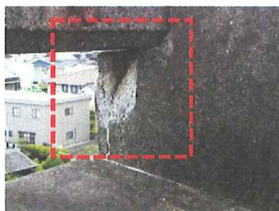
〔 パラペット部分のひび割れ 〕
