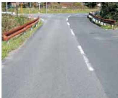
錆びたガードレール
