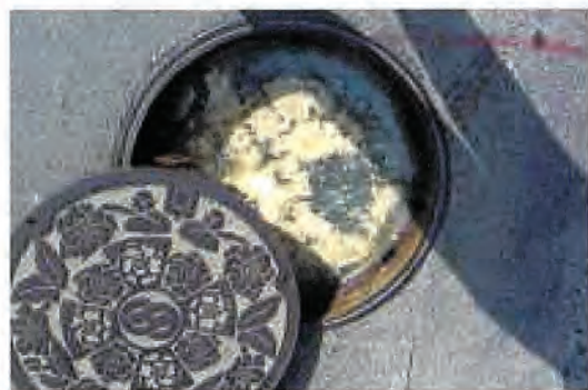
〈下水管閉塞によりマンホールが汚水で一杯になった状況〉
