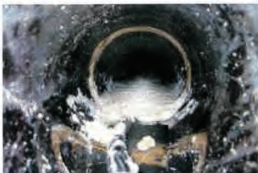
〈下水管が油で閉塞した状況〉
