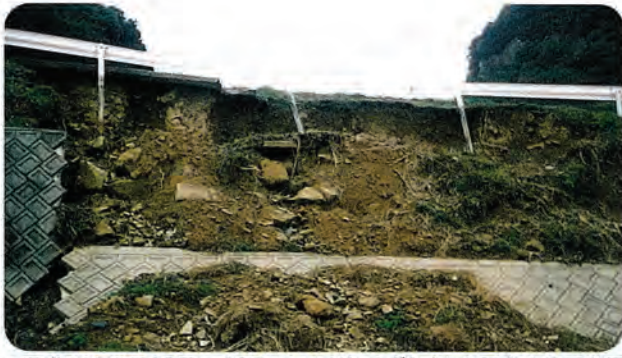
▲平成14年9月16日の大雨によるガケくずれ(志方町内会前田地区)
