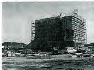
浸水解消のため完成が待たれる小浦都市下水路整備事業ポンプ場
