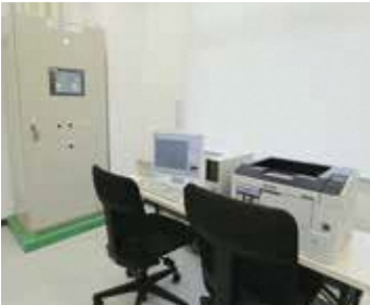
管理室(1階) し尿等前処理施設の運転を管理します。
