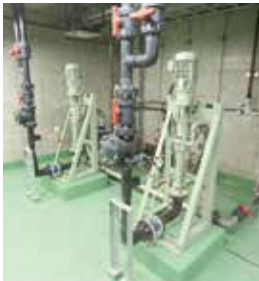
し尿投入ポンプ (地階) 前処理したし尿・浄化槽汚泥を希釈し、佐々浄化管理センター分配槽に投入します。
