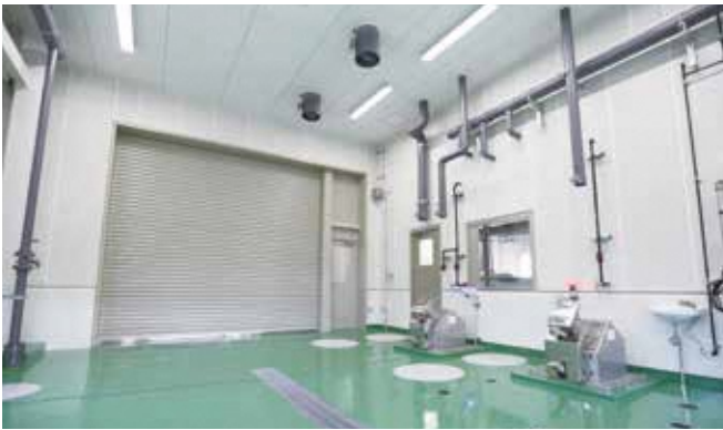
受入室(1階) し尿・浄化槽汚泥を受入口から投入します。
