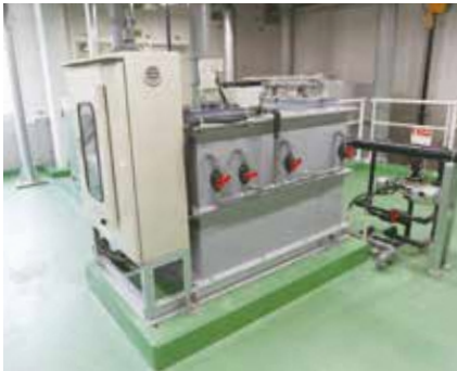
微生物溶解装置(1階) 微生物資材投入による油脂分の分解、硫化水素の抑制作用で臭気を低減します。
