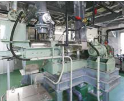
きょう雑物脱水装置(1階) きょう雑物(ごみ)を脱水して施設の外へ搬出します。
