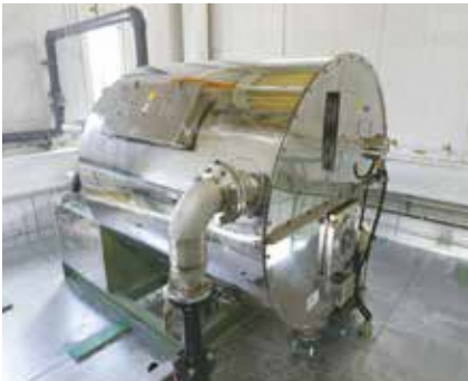
きょう雑物除去装置(2階) し尿・浄化槽汚泥に含まれるきょう雑物(ごみ)を取り除きます。
