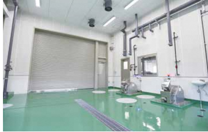
受入室(1階) し尿・浄化槽汚泥を受入口から投入します。
