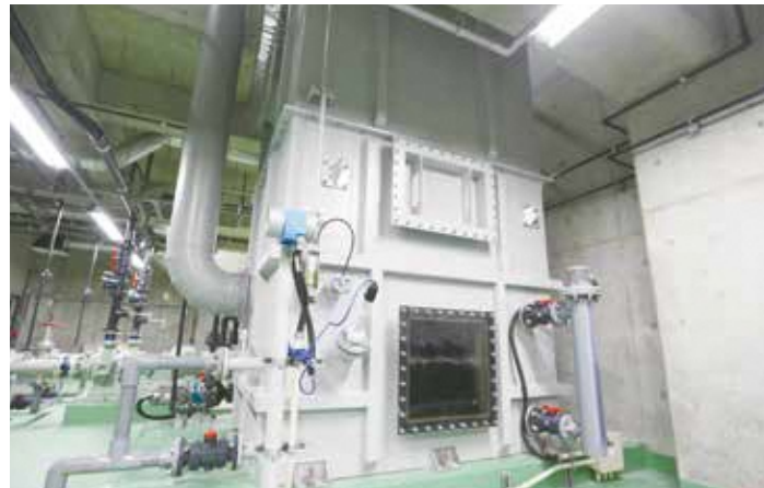
生物脱臭塔(地階) 微生物が臭いの元となるものを取り除きます。
