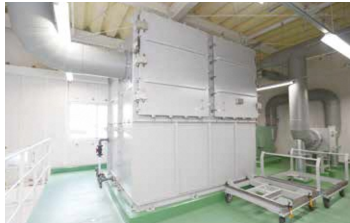
活性炭吸着装置(2階) 活性炭で臭いの元を取り除いて、空気中に放出します。
