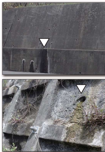
地下水の流出
