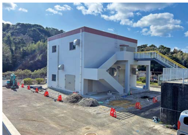
浄水場送水ポンプ室
